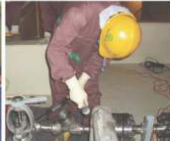
원자로 Y-Check Valve
